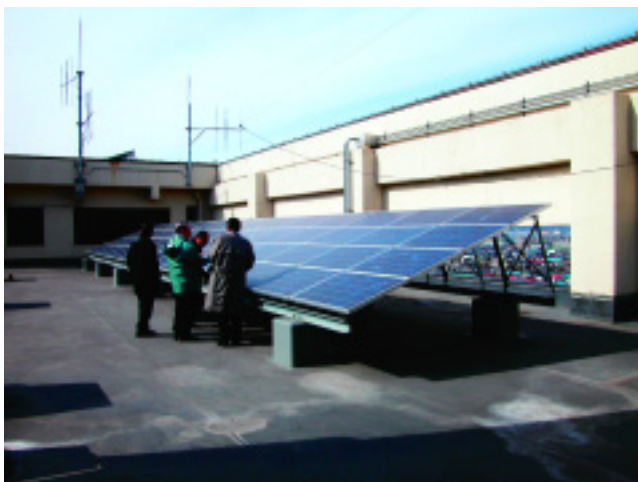
市庁舎本館屋上に設置された太陽光発電パネル
