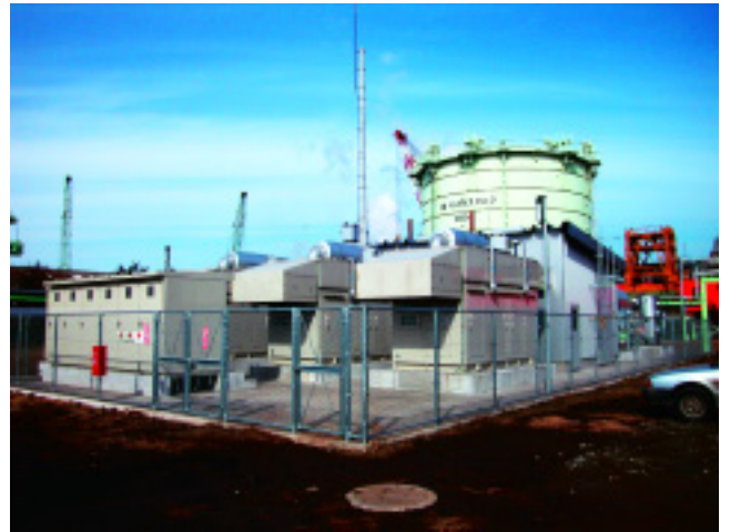
消化ガスを燃料にして発電するガスエンジン発電機が3基設置されている
