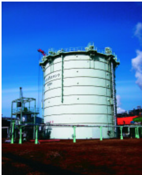
汚泥消化ガスを貯留するガスタンク
